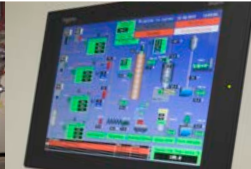
Pannello di controllo dell'impianto di saponificazione.
